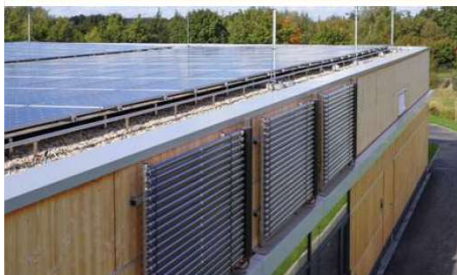
Eco Quartier des Noe, Val de Reuil Toiture photovoltaïque
